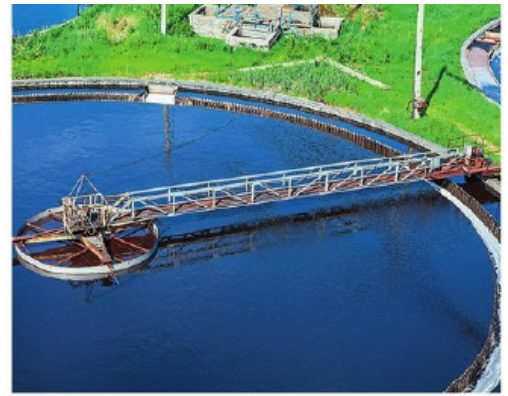
> Station de traitement des eaux usées
